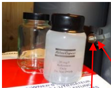
Oljeseparator sjekk: Tapp vann ut av ventil. Vannet sjekkes mot referanse- flaske.
