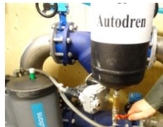
Autodren under vannutskiller er helautomatisk. Mulighet for å bruke "by pass" hvis autodren svikter. Sjekk!
